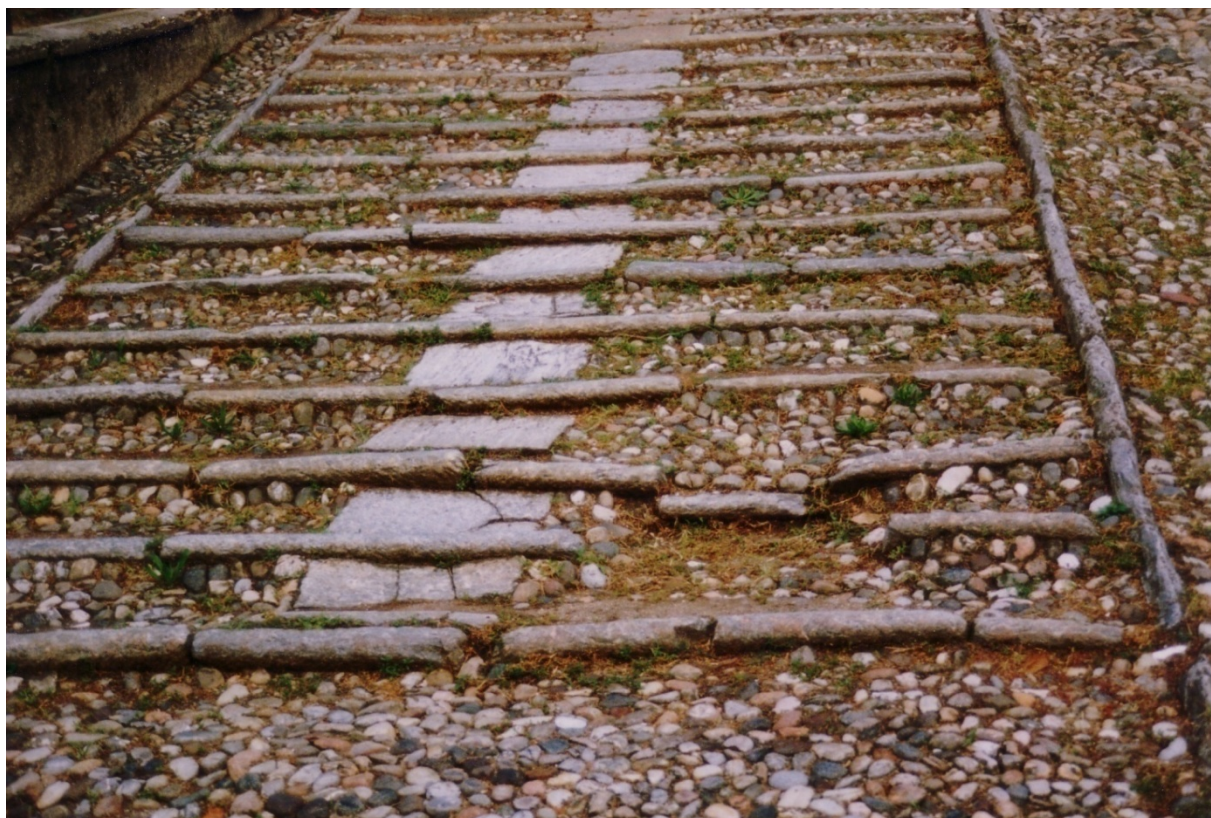
La situazione di abbandono e degrado appare evidente
